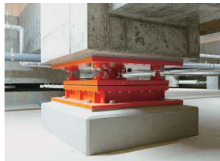
▲微振動対策ダンパー (WSD-3, 2-100:2基設置)
