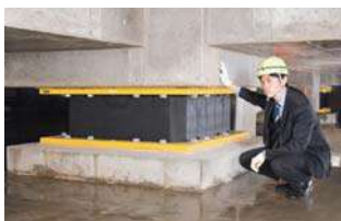
免震装置(積層ゴム)
