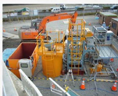
▲脱水処理設備
