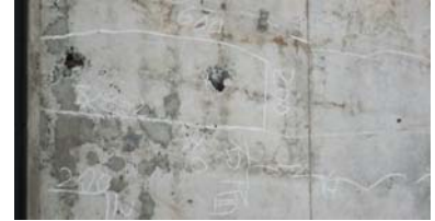
初期欠陥によるジャンカ
