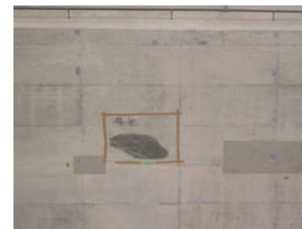
< 調査・補修後 >
