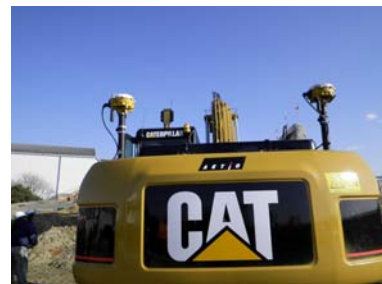
写真-2 GNSS(GPS)アンテナ
