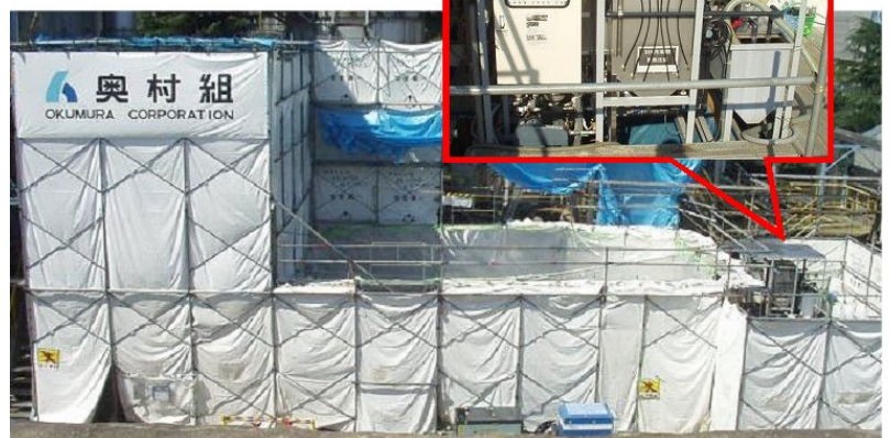
排水処理システムの実用現場
