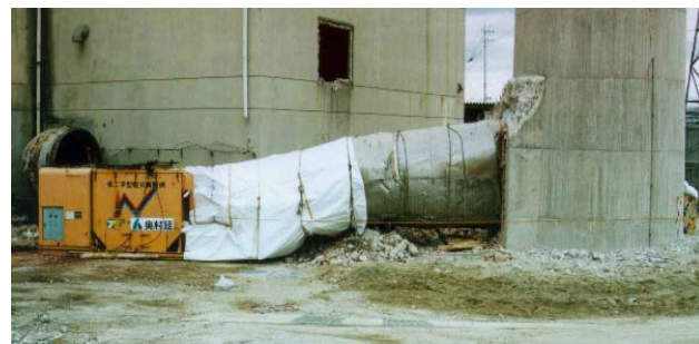
煙突下部に装備した負圧除塵機
