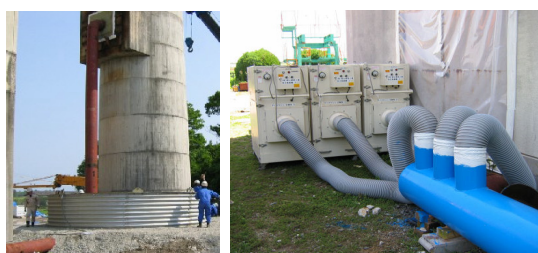
吸引配管(左)と負圧集じん機(右)
