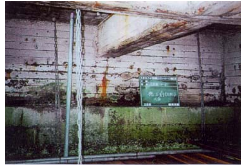
写真-1 塩害劣化による栈橋の腐食例
