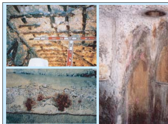
写真-1 下水道施設の腐食劣化事例
