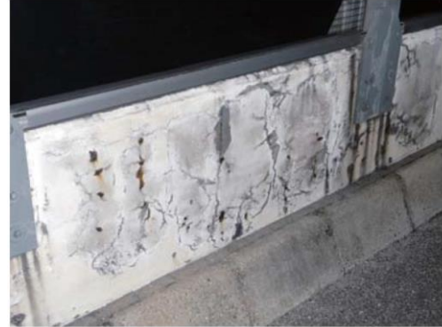
防護柵の劣化状況
