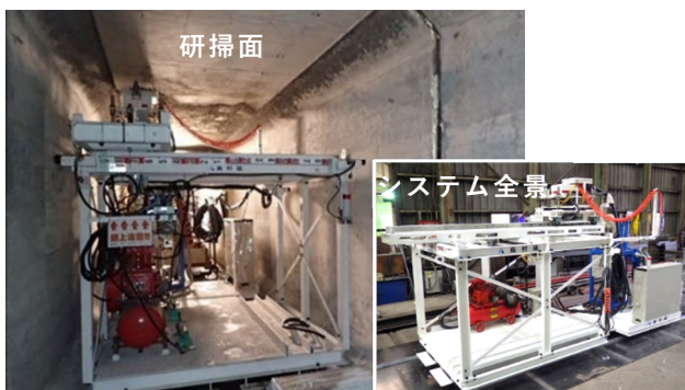
下水道施設放流渠 適用状況
