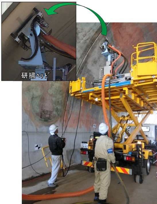
写真-3 自動化運転状況
