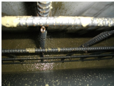
写真 4 流動状況(壁部)
