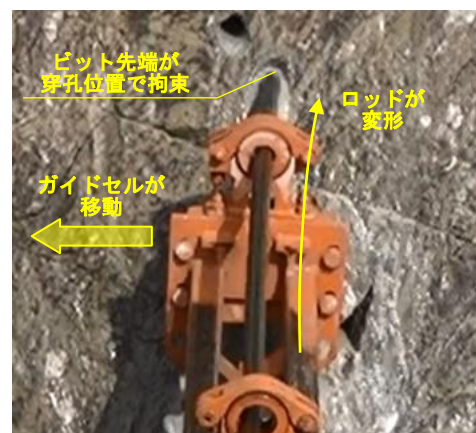
写真－１ ロッド変形状況
