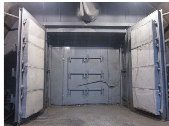
写真-1 改造後の防音扉
