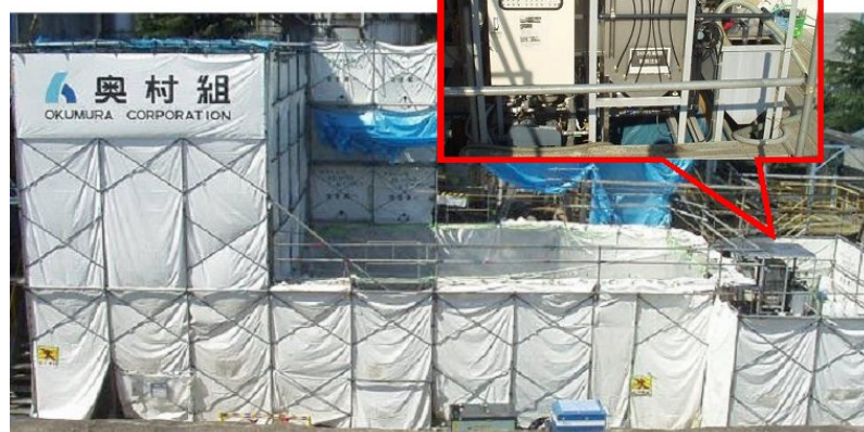
排水処理システムの実用現場
