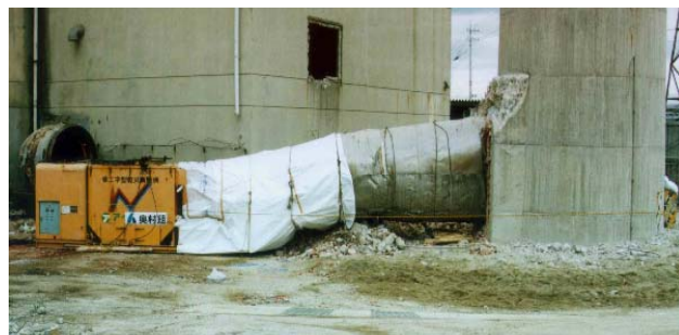
煙突下部に装備した負圧除塵機
